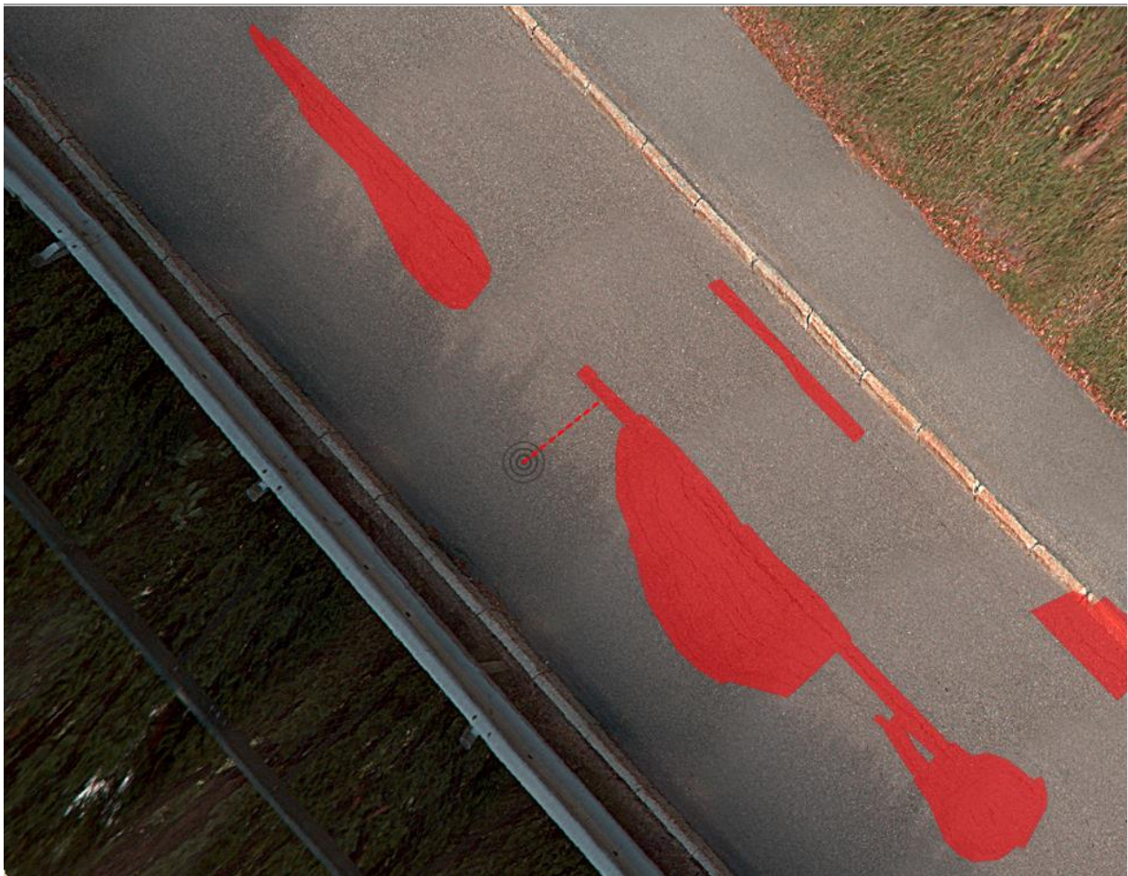
Figur 9. Her er vist lokale dekkeskader og skadet delareal som resultat av skannet vei
